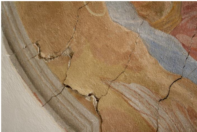
Obrázek 3 Oddělené omítky stropu. Technické i estetické důvody pro provedení injektáže.
