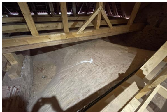
Obrázek 7 Grout vyteklý na vnější straně klenby.
